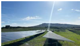
Gallo Assunta PV Plant 1 MW
